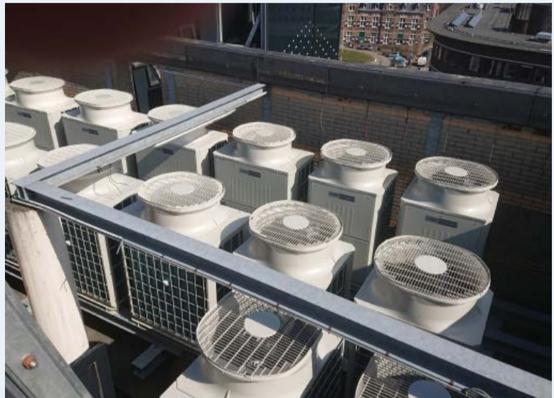
De warmtepompen van het City Multi VRF R2-systeem zijn gegroepeerd in verschillende technische buitenruimtes op het dak.
